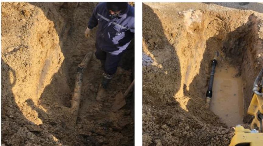
Picture 2. PE pipe failure
